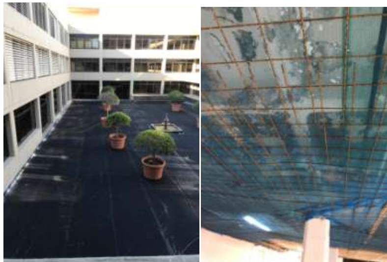
Edificio Administrativo de Servicios Múltiples de Mallorca. Lámina impermeabilizante en el patio y red en el aparcamiento.
